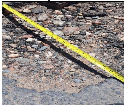
Figura 3 - Desnívelamento com afundamento no pavimento de 21 cm de largura e 9 cm de profundidade
