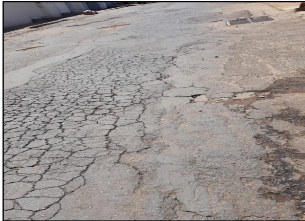
Figura 9 - Trincas do tipo couro de jacaré sem erosão
