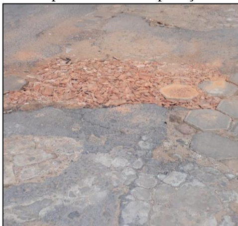
Figura 4 – Desnívelamento com fundamento no pavimento preenchido com pedaços de telha
