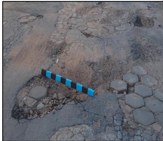
Figura 2 - Desnívelamento com afundamento no pavimento
