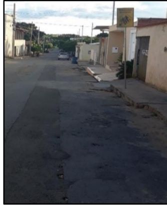
Figura 1 - Trincas longitudinais no pavimento
